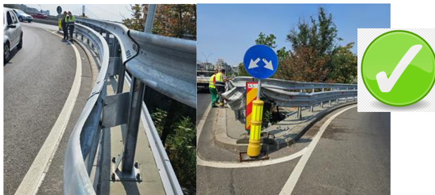
Figura 4, 5: Detalii coliziune parapete Pasaj Podul Grant, București. Accident soldat cu rănirea ușoara a conducătorului auto
